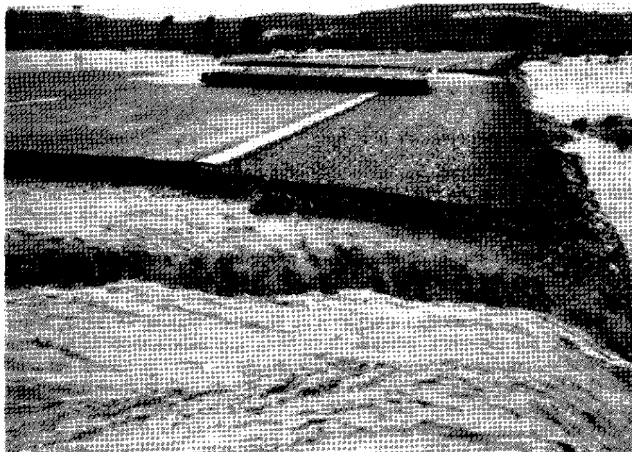
Carretera Nacional 340. Les aigües arrancaren i arrossegaren el paviment
