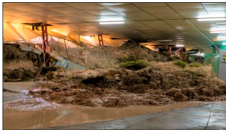
Figura 2. Interior de la nau industrial el 13-04-2022, on s'aprecien els danys generats a una de les fàbriques i la conseqüent evacuació dels treballadors
