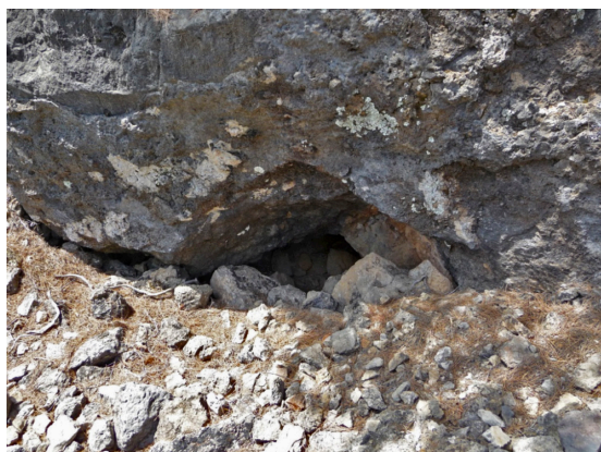
Fig. 2. Derrumbes recientes cegando una entrada o arranque de galería (Foto: M. H. Hermanns 2012).
