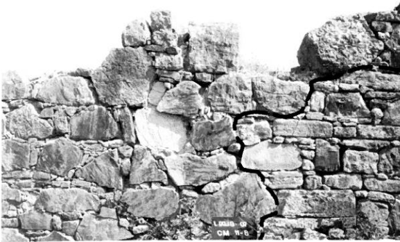
1.3. Fig. 2. Muro CM.VIII (ver fig. 6) en el que se aprecia la superposición de la obra B sobre la A.
