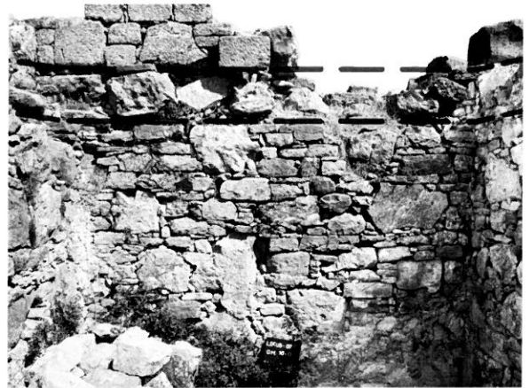
1.3. Fig. 3. Muro CM.III (fig. 6) en el que se aprecia en su zona inferior el paramento conocido como à pilettes, sobre el que se han levantado elementos estructurales, indicados por los trazos discontinuos, que revelan la existencia de un piso superior.
