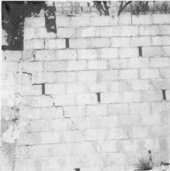
Foto 2.-Muro de contención de una terraza en una residencia secundaria, fracturado y desestabilizado a resultas del deslizamiento, y que tan simple pared de bloques no puede detener, con el consiguiente peligro.
